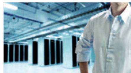
Verifica del locale di funzione, per il rispetto delle normative
